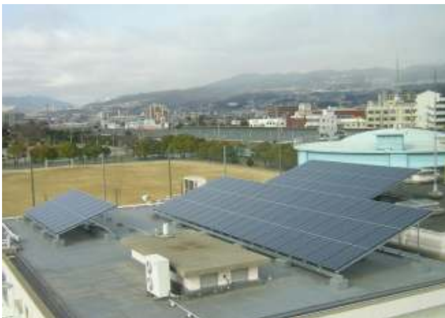
久代浄水場 太陽光発電
