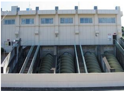
前川雨水ポンプ場
