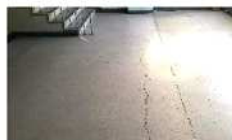
■ 床仕上げひび割れ状況
