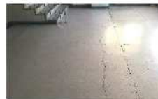
■ 床仕上げひび割れ状況
