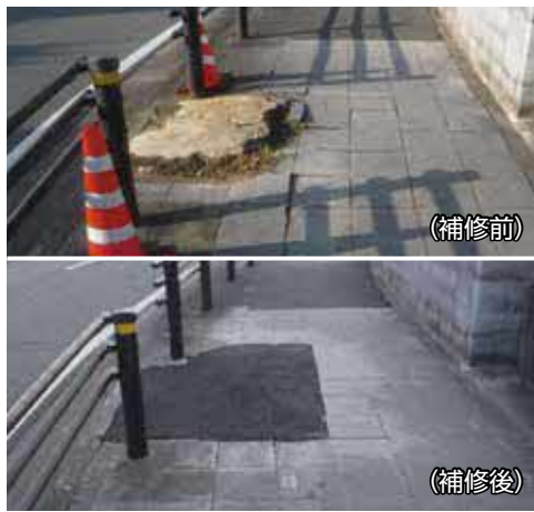
街路樹の根上がり
