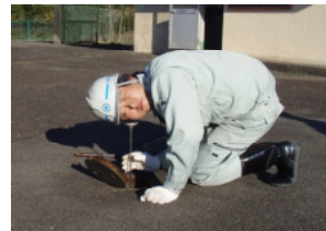
送配水管の管理
